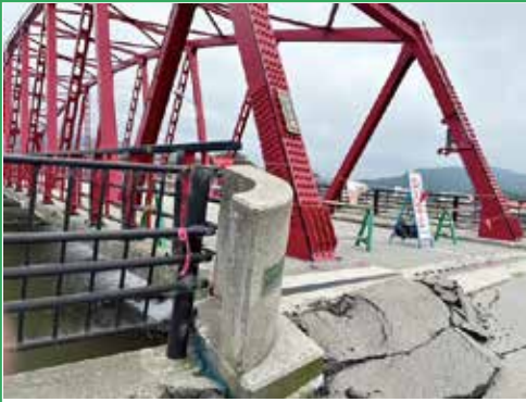
海岸部隆起の影響により通行できなくなった橋梁(輪島市)
